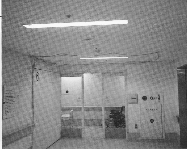
写真-2 病棟通路の天井に設置されたトリガーアンテナ(同軸ケーブル製)
