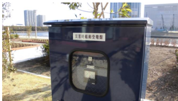
図10 災害時船舶受電盤
