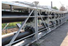
パイプコンベア
