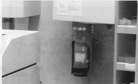
写真5 病院内で使用されている気送管 (ソウル、サムソン病院)
